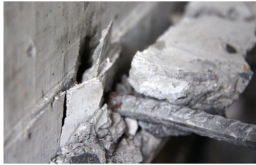
(a) WSJ1 楼板受拉钢筋周边混凝土锥形破坏
