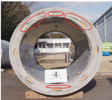
图 4 修复后的管道试件在荷载达到 P_c 前脱离 [5]
