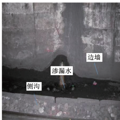
(b) 衬砌渗漏水
