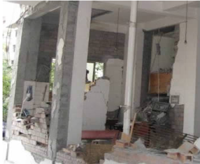
图 6 部分倒塌或全倒塌
