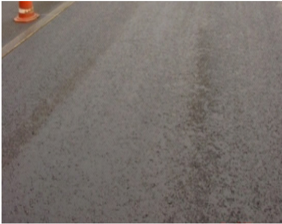
图 1 再生混合料拌和分散不良造成的路表缺陷
