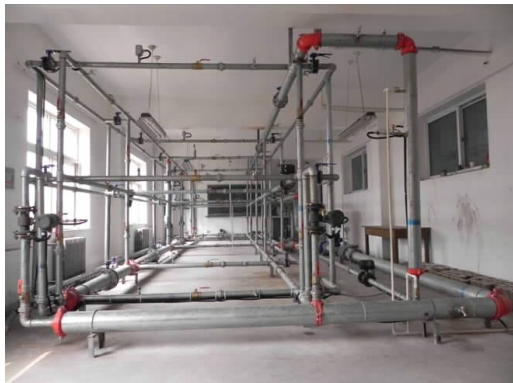
图1 供水管网仿真模拟实验平台
