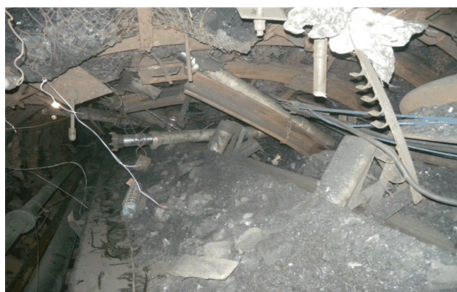
图 1 冲击地压造成的巷道破坏
