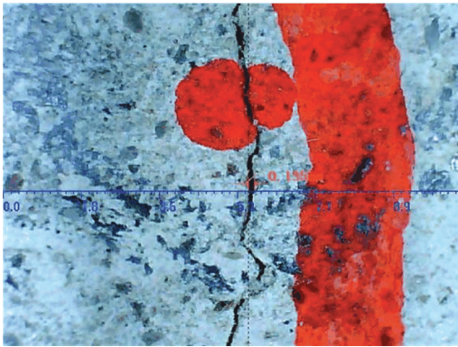
(b) 裂缝宽度
