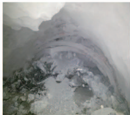
图2 装矿进路钢拱架压弯
