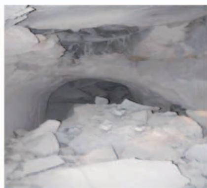
图1 出矿穿脉垮塌
