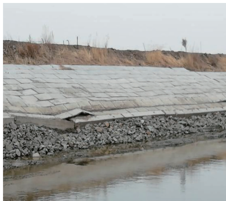
(a) 分散土渠道冻胀破坏
