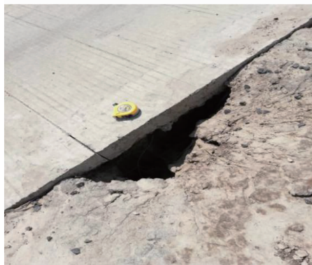
(b) 分散土路基侵蚀破坏
